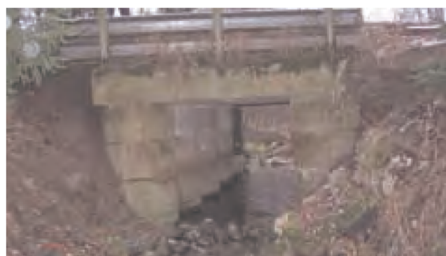
Leppojan vanha silta, maasortumat ja kaivonrengaspilarit.
