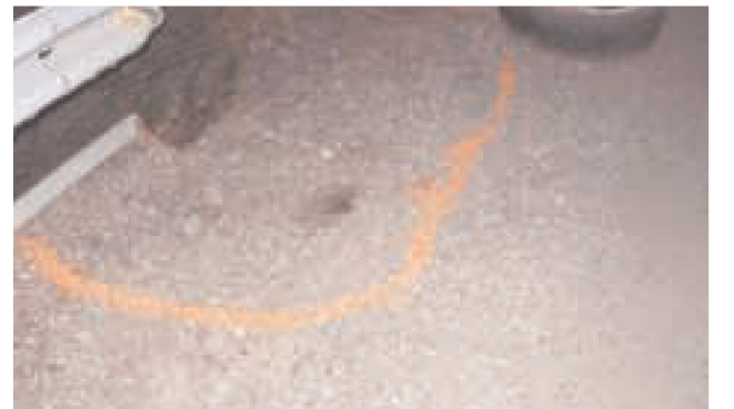
Leppojan sillan päällä havaittu reikä.
