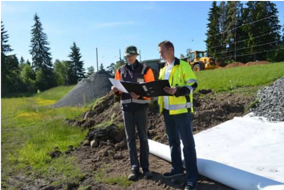
Kunnan työpäällikkö Osmo Hongisto tarkastelee Vartiolan kentän remonttisuunnitelmia Kaskenoja Oy:n työnjohtajan Lasse Kivekkään kanssa.
